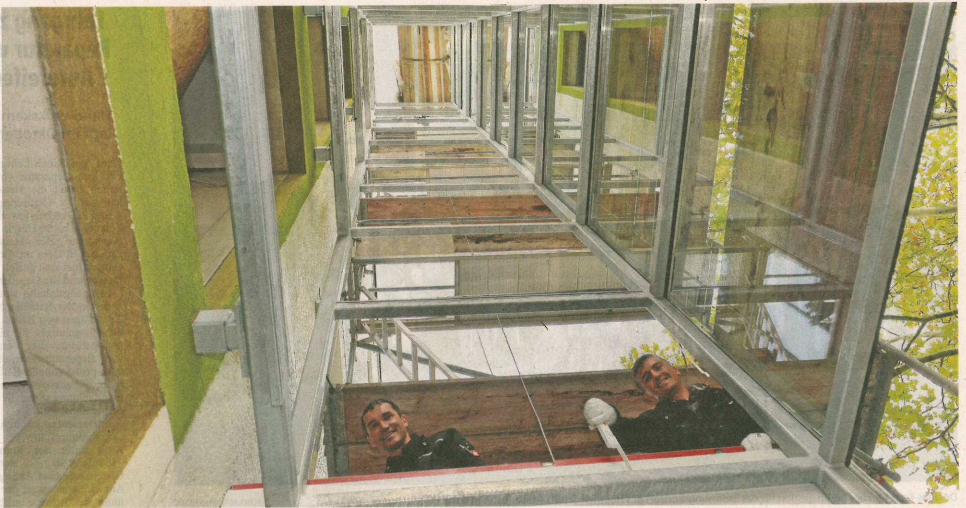
Jens Trommer (links) und Benjamin Seidel von Metallbau Weber aus Reuth im Vogtland montieren mit ihren Kollegen den neuen Fahrstuhl, über den künftig der Zugang für 20 Wohnungen erleichtert wird. FOTOS: PETER MICHAELIS
