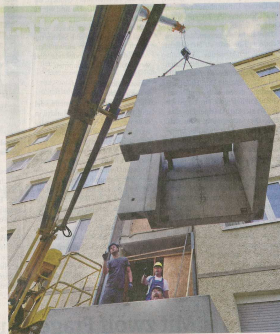
Die Wohngenossenschaft Neuer Weg saniert in der Saalfelder Straße 21-25 in Lusan insgesamt 45 Wohnungen. Am Dienstag wurde am zweiten von drei Aufgängen der Schacht für den Außenfahrstuhl mit Hilfe eines Kranes angebaut.
